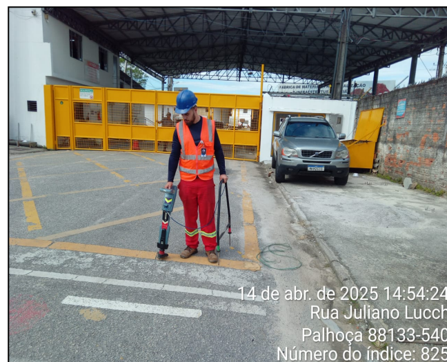
Figura 5 – Inspeção do duto - Ramal Sinasc Ø2”.
